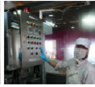
【写真左：蒸気釜】ホエーからセラチーズを作る時や、煮沸消毒に利用 【写真中：滅菌庫】器具類の消毒をする場所 【写真右：制御盤】チーズ・工程・その日の気温などの状態により、機械へ様々な調整を行う
